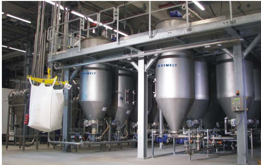
Bild 2: Rohstoff-Annahme, -Lagerung, -Dosierung und Förderung
