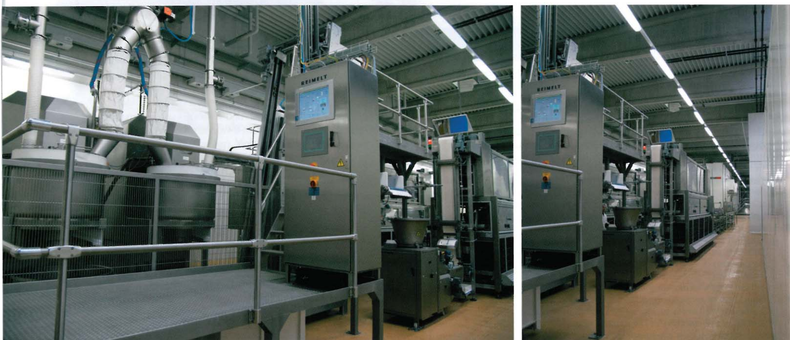
Für Spezialbrote wurde eine Linie von Mecatherm installiert.
